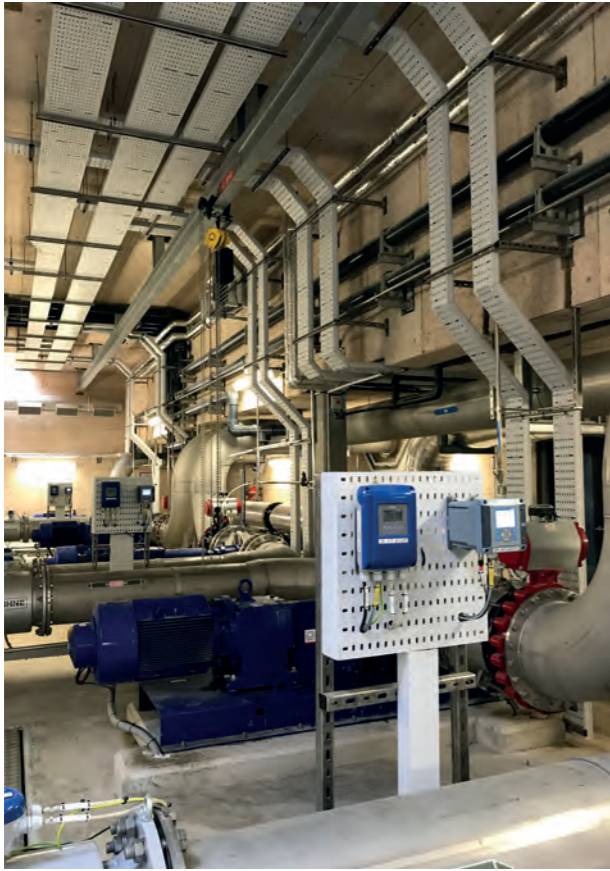
Tratamiento de aguas: EDAR
