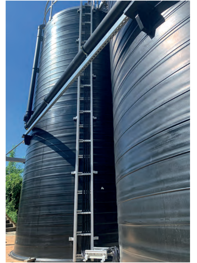
Tratamiento de aguas: EDAR
