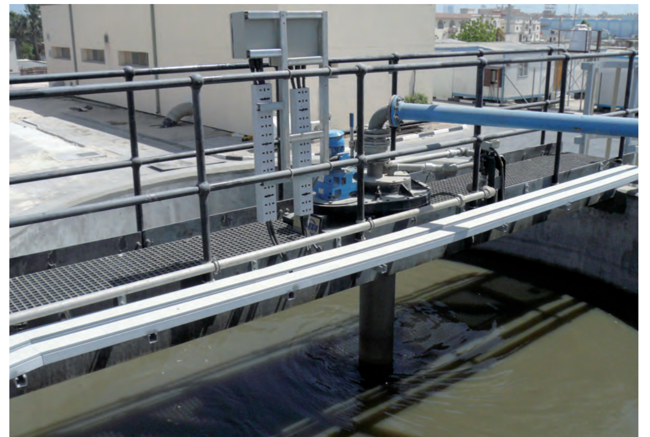
Tratamiento de aguas: EDAR
