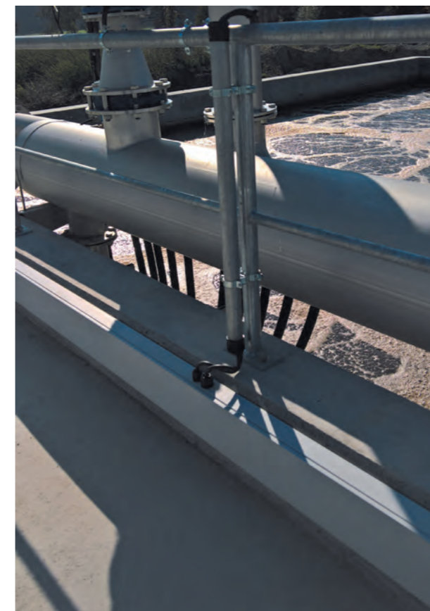
Tratamiento de aguas: EDAR
