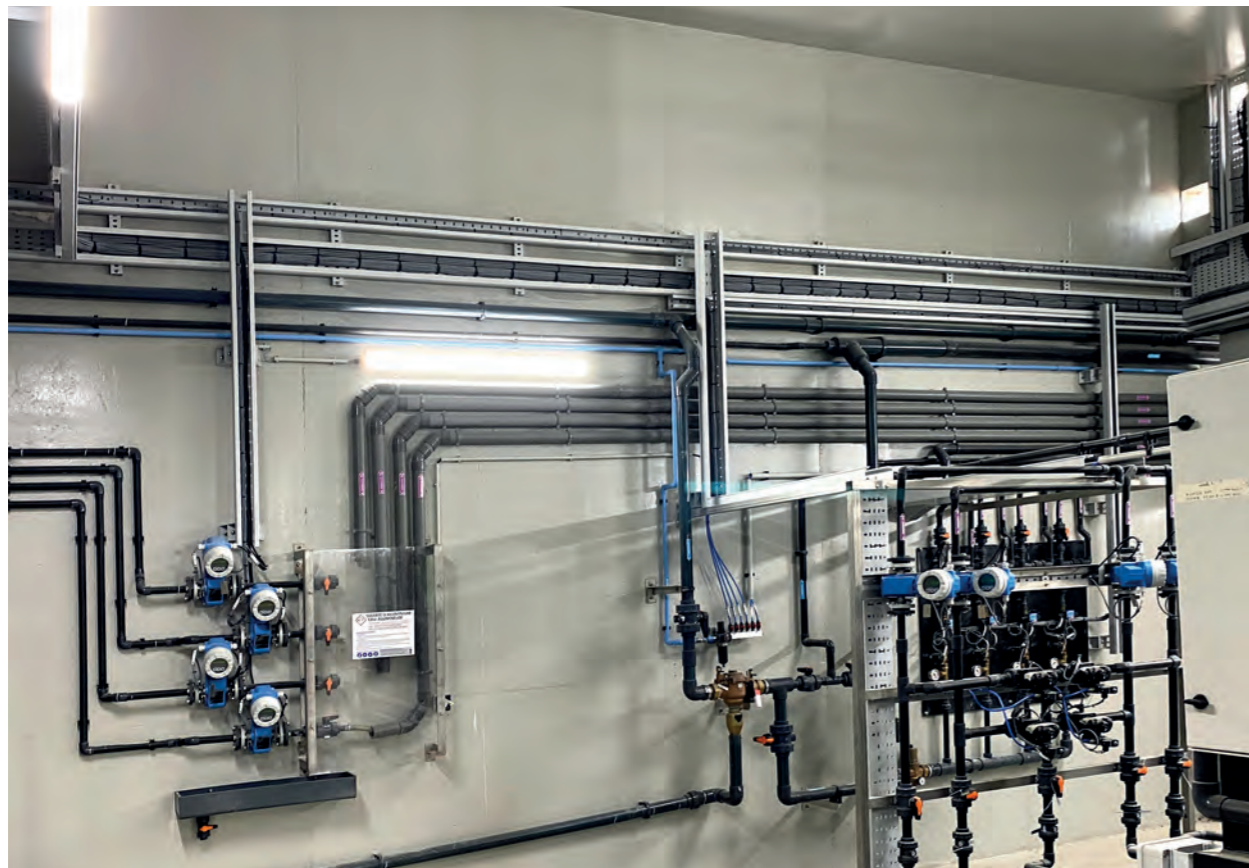
Tratamiento de aguas
